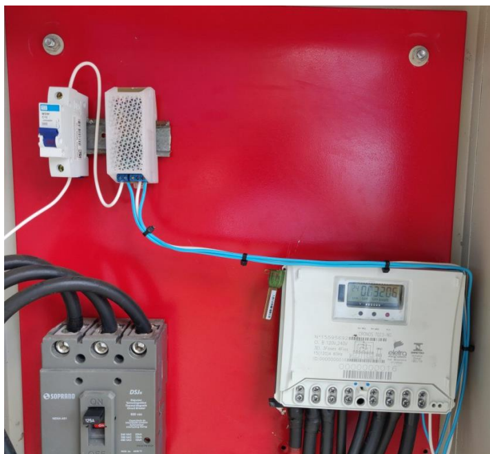
Instalação com medidor comercial
